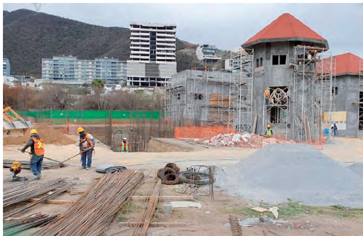
Fig. 16. Museo La Milarca en construcción. 2021. San Pedro Garza García (Nuevo León, México). Foto El Norte (Monterrey)
