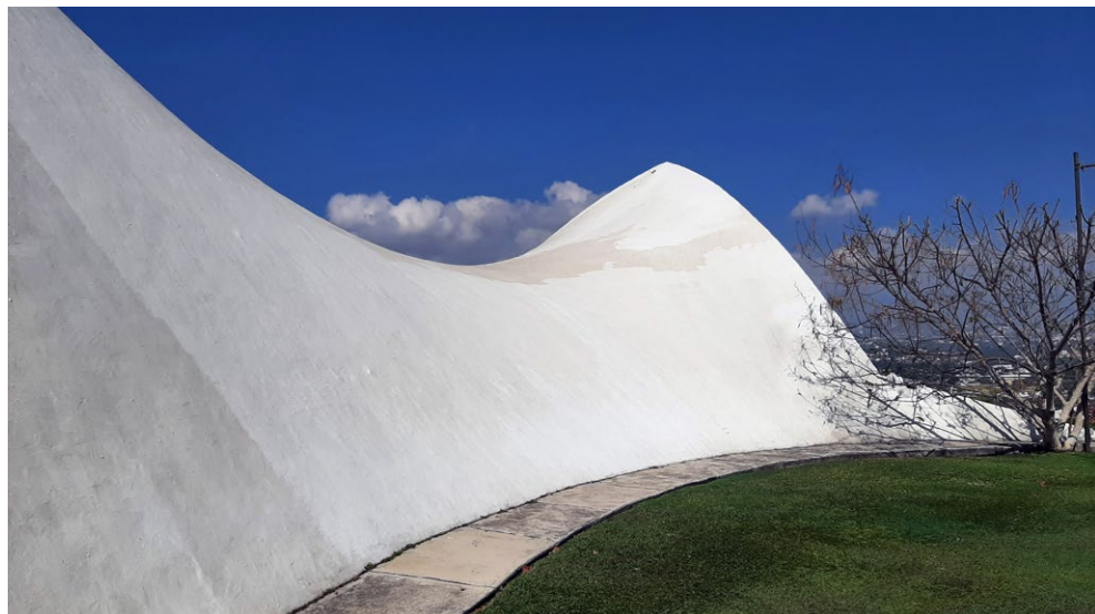
Fig. 14. Capilla de Palmira (vista parcial de la cubierta) . Félix Candela y otros. 1958-1959. Lomas de Cuernavaca (Cuernavaca, Morelos). Foto del autor
