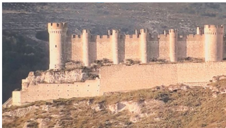
Fig. 3. Lienzo de muralla reconstruido, formado con tres líneas de mechinales cuadrados, en el siglo XX. Nótese la diferencia de color en los sillares del muro. Fotografía del autor
